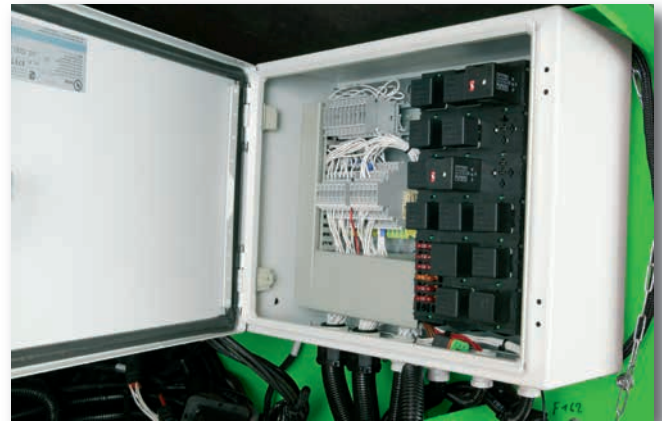
Übersichtlicher Elektroverteiler mit klarer und deutlicher Beschriftung – leichte und schnelle Fehlerdiagnose
