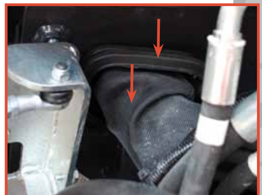
Schutzummantelung bei Schlauchdurchführung in Metallrahmen.
