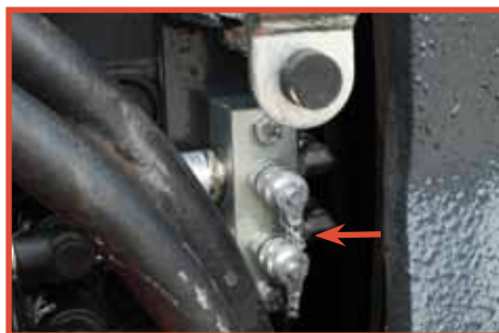
Schnellanschlüsse zum Ablesen der Pumpendrucke.
