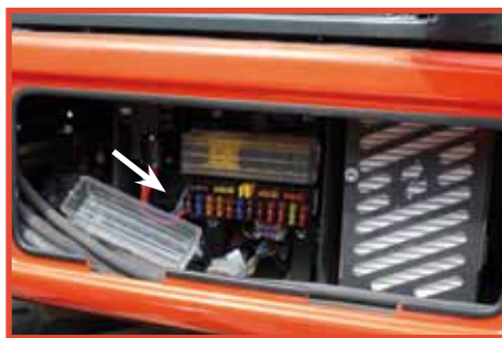
Isolierter Sicherungskasten und Computer- Diagnose- Anschluss.
