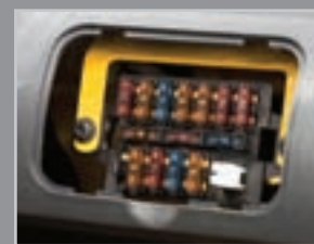
Gut erreichbarer, kompakter Sicherungskasten für einfache Wartung
